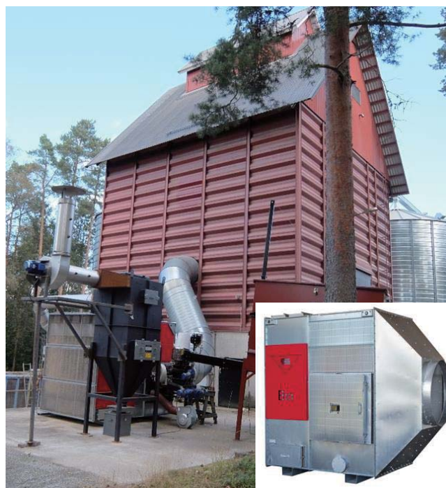
写真 4 併設の木質チップ利用乾燥施設 (右: BioHeater 本体)
