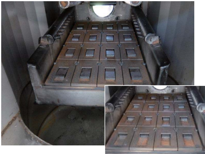
写真5 BioHeater ストーカー炉内部
